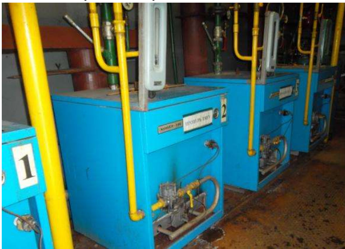
Рис. 1.2.2. Внешний вид котлов котельной № 0615
