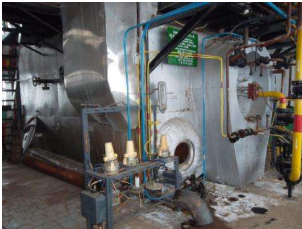
Рис. 1.2.1. Внешний вид котла № 4 котельной № 0614, выведенного из эксплуатации
